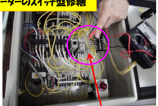
●電気回路の導通チェック
